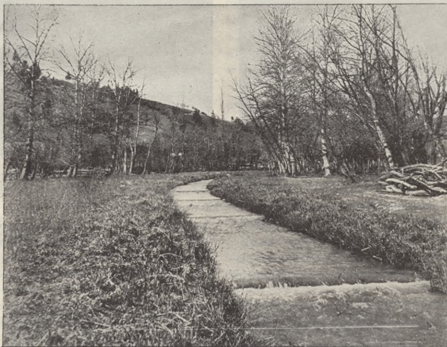
Ryc. 6. Regulacja progowa na potoku Czarna woda — brzeży ubezpieczone opaskami systemu Seelinga.
