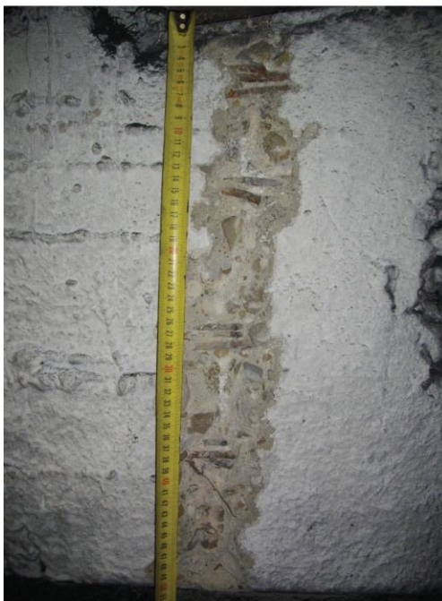
Rys. 7. Odkrywka czoła krótkiego wspornika
