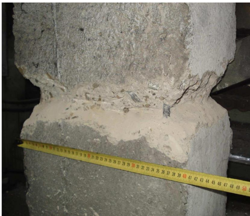
Rys. 3. Odkrywka zbrojenia gałęzi słupa
