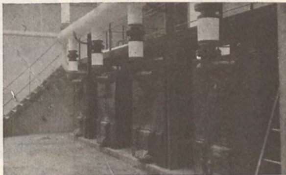
CHAUFFERIE RUE DU DOCTEUR-LANDOUZY
