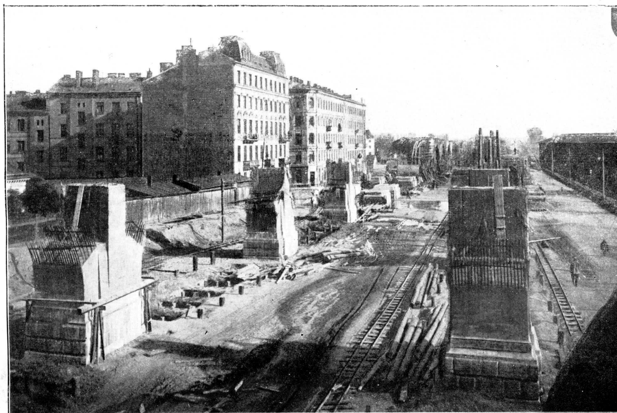
ILUSTR. 55. WIDOK PODSTAW FILARÓW WIADUKTU.
