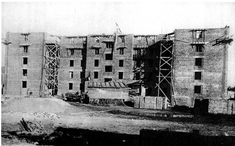
Budowa II Domu Akademickiego: Stan budowy w maju 1925 ( u góry ) i we wrześniu 1925 ( u dołu )
