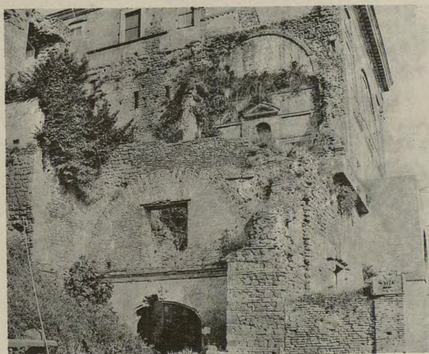
Bild des Verfalles (Südfront).
