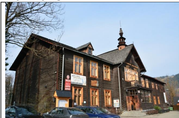
[28] Szkoła Snycarska, 1882–1883, przy ul. Krupówki, proj. Antoni Łuszczkiewicz. Szalunek deskowy przykrywa szkieletową konstrukcję drewnianą. Fot. aut.
