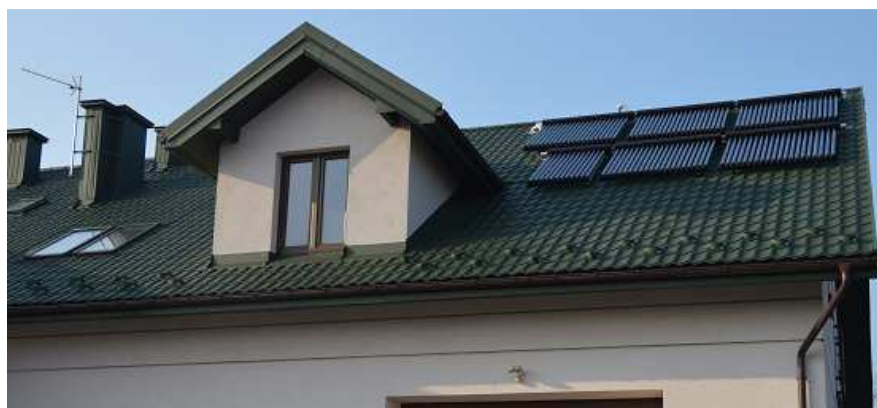
Rys. 3.3. Zdjęcie południowo-wschodniej fasady budynku wraz z kolektorami słonecznymi
