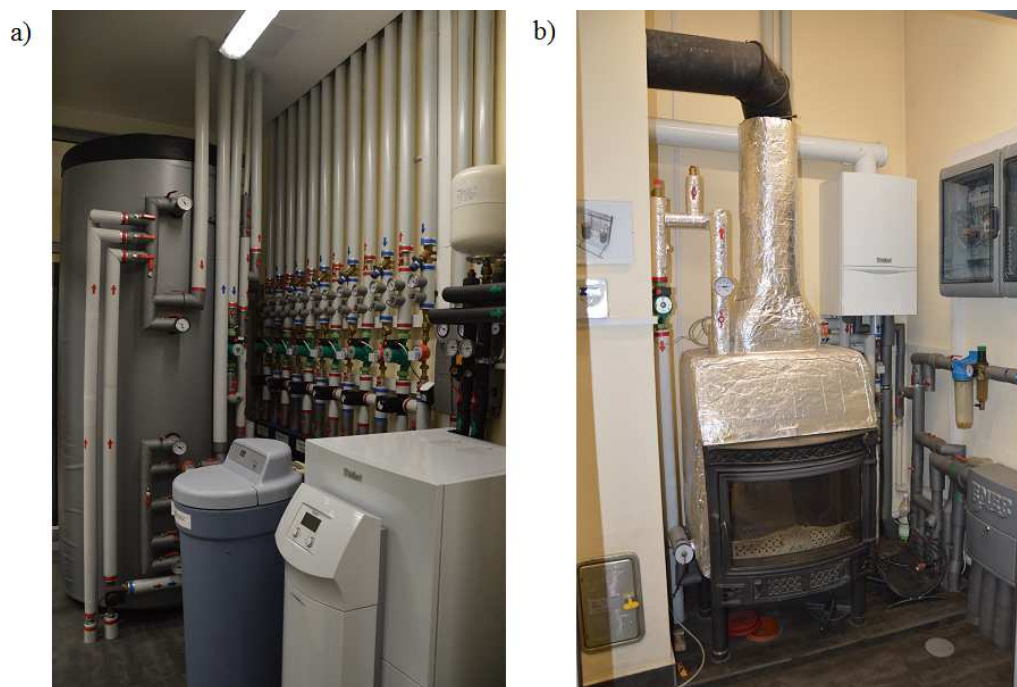
Rys. 3.10. Fotografie instalacji: a) od lewej zbiornik buforowy, demineralizator, pompa ciepła; na dalszym planie elementy obiegów grzewczych b) kocioł na biomasę, kocioł gazowy
