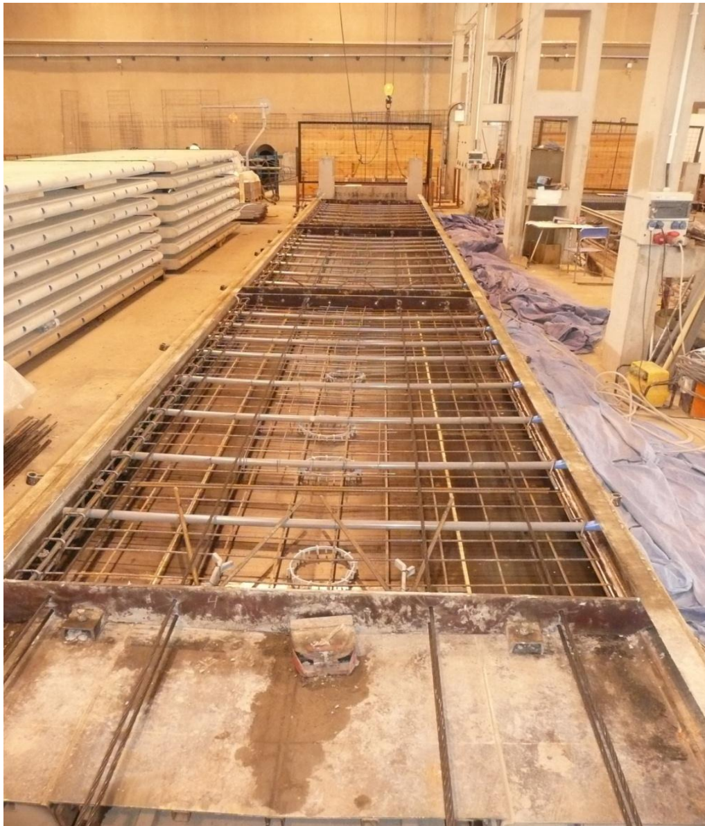
Rys. 9.1 Ogólny widok toru naciągowego przed ułożeniem betonu (agregaty naciągowe u góry rysunku)
