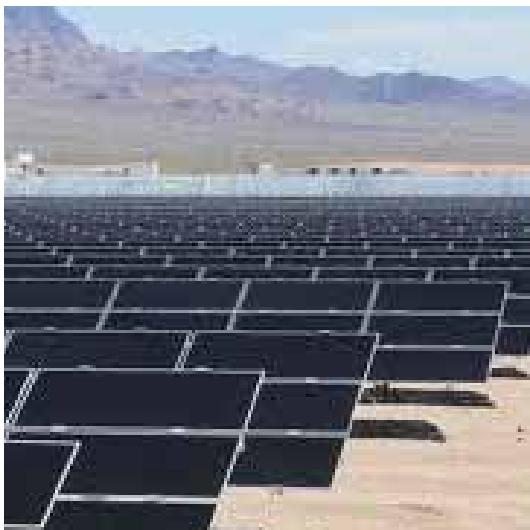
6.21. Elektrownia fotowoltaiczna, Gila Bend, Arizona (fot.: autorka, 2012)
