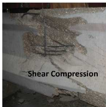
Rys. 3.9. Zniszczenie od zmiżdżenia betonu [92]
