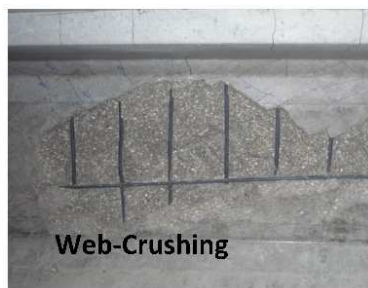
Rys. 3.8. Zniszczenie od zmiżdżenia betonu w środkniku belki [123]
