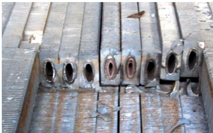
Rys. 7.10. Widok rur wymiennika ciepła z osadami kamienia kotłowego (zdjęcie wykonane po awarii urządzenia)
