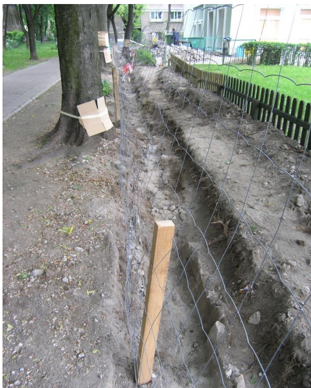
RYC. 66. DEMONTAŻ STAREGO MURKA COKOŁOWEGO OGRODZENIA ŻŁOBKA – CZYNNIK POWODUJĄCY ZABURZENIE STABILNOŚCI DRZEW, 2006, FOT. M. SIEWNIAK
