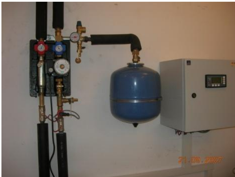
Rys. 6.3. Widok zespołu pompowego wraz z rejestratorem elektronicznym
