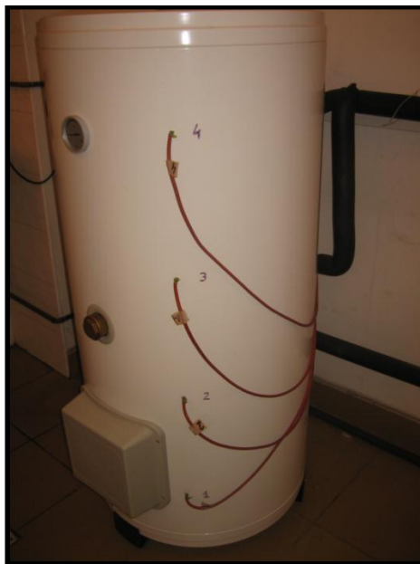
Rys. 6.4. Widok zasobnika ciepłej wody użytkowej z dodatkowymi punktami pomiarowymi do badania stratyfikacji termicznej (16 punktów)
