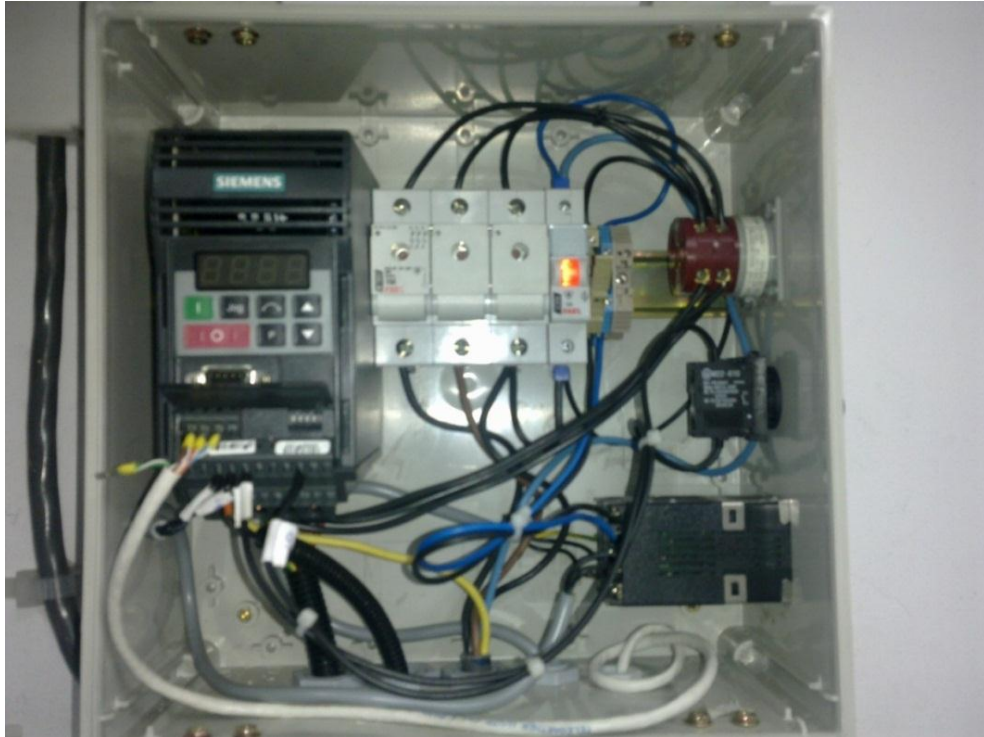
Rys. 36. Szafka sterownicza, falownik bezpośrednio połączony z komputerem stanowiska badawczego
