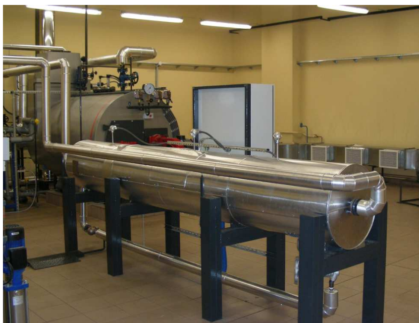
Rys. 3.2.1. Instalacja do badań komputerowych układu do ciągłego nadzoru eksploatacji energetycznych kotłów parowych
