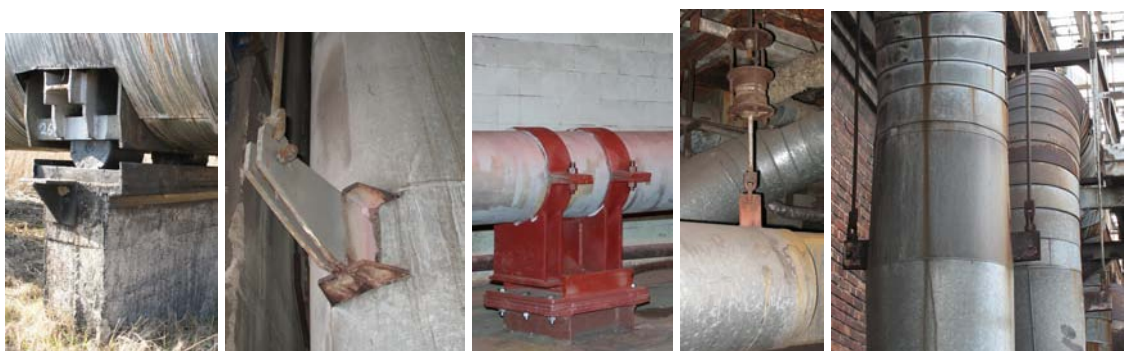
Rys. 4.3. Rurociągi – przykłady zamocowań z elementami stanowiącymi mostki termiczne (których fragmenty są widoczne i wystają ponad izolację)
