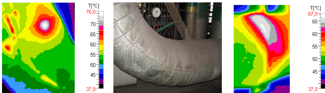
Rys. 4.13. Zdjęcie i termogramy powierzchni izolacji kolana rurociągu parowego: fragment kolano 90^{\circ} ( t_{\min} = 35,0 \text{ }^{\circ}\text{C} , t_{\max} = 74,8 \text{ }^{\circ}\text{C} ) i prostki ( t_{\min} = 40,2 \text{ }^{\circ}\text{C} , t_{\max} = 66,9 \text{ }^{\circ}\text{C} ) z „nieoczekiwanymi” mostkami termicznymi spowodowanymi nierównomierną grubością lub nieciągłością izolacji właściwej na obwodzie
