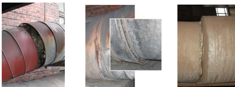
Rys. 4.8. Nieprawidłowości izolacji rurociągów energetycznych stanowiące mostki termiczne, generujące straty ciepła (niestaranne założenie i przesunięcia izolacji)
