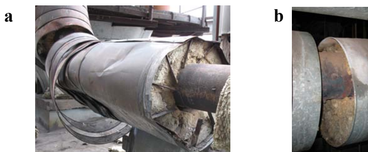
Rys. 4.7. Nietypowe mostki termiczne rurociągów energetycznych: a) – deformacje płaszcza zabezpieczającego i konstrukcji wsporczej, b) – obwiśnięcie izolacji rurociągu usytuowanego poziomo
