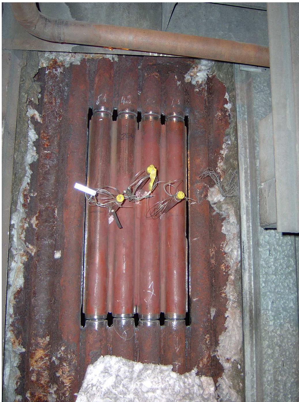
Rys. 3.13. Układ pomiarowy w kotle K6 przed wykonaniem spoin obwodowych rur ekranowych. Widok od strony zewnętrznej kotła.
