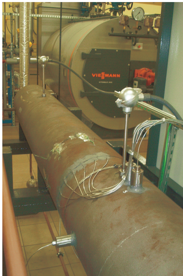
Rys. 9.5. Widok opomiarowanego kolektora parowego przed założeniem izolacji cieplnej [27]
