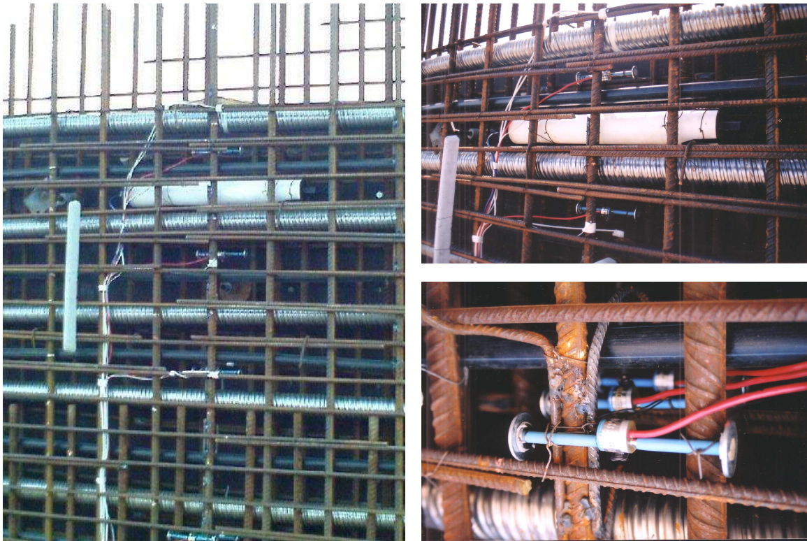
Fot. 5-2 Widok przetworników odkształceń i naprężeń w przekroju przęsłowym (A-A) dolnego segmentu ściany.
