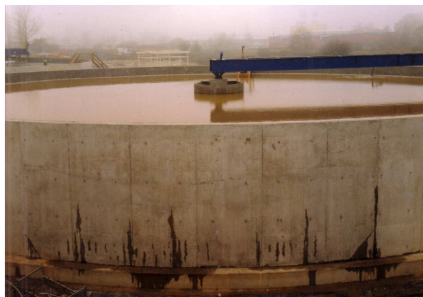
Fot. 1-1 Widok porysowanej od skurczu termicznego i przeciekającej ściany zbiornika utwierdzonego w dnie.
