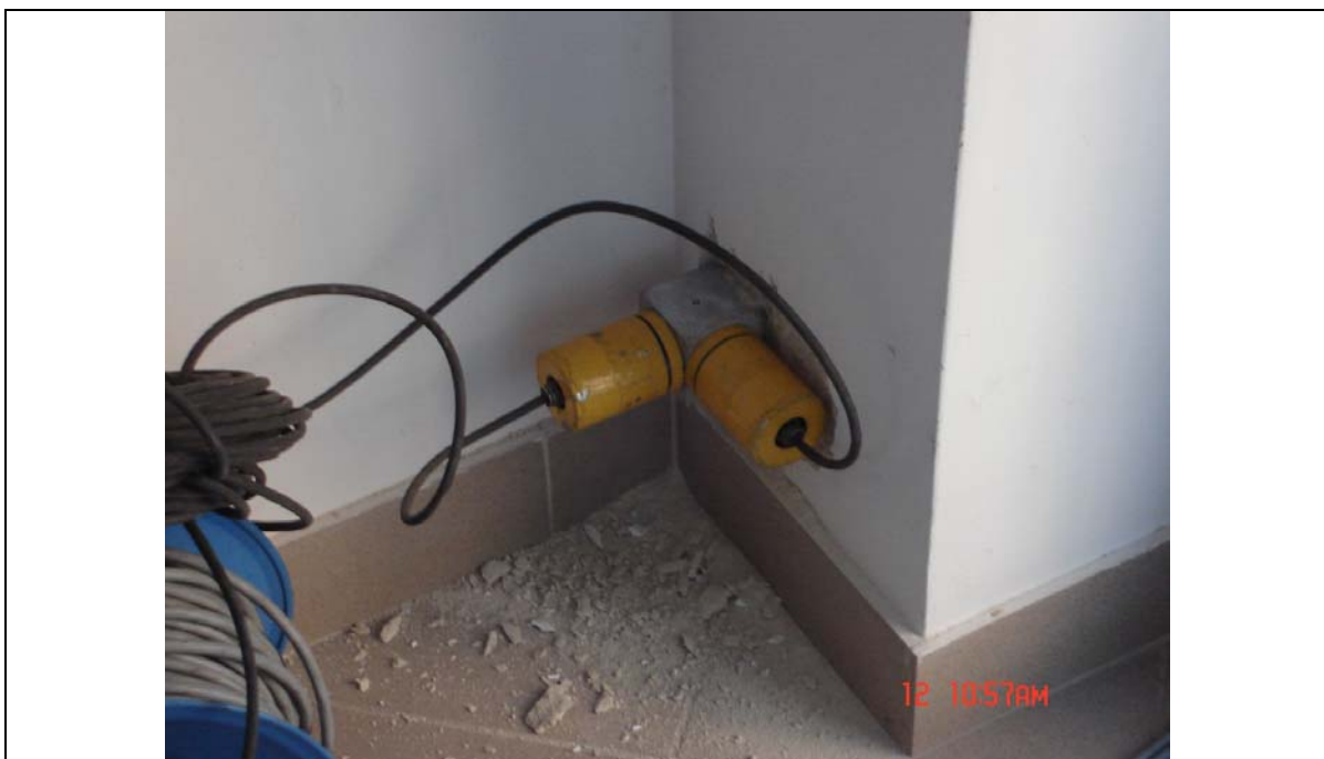
Fot.4.6. Czujniki z osłonami zabezpieczającymi.
