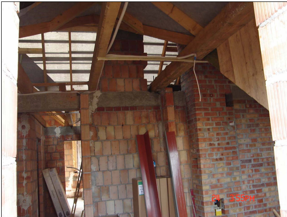
Rys. 7.29. Widok połączenia żelbetowej ramy ze ścianką działową na poddaszu w budynku C3.
