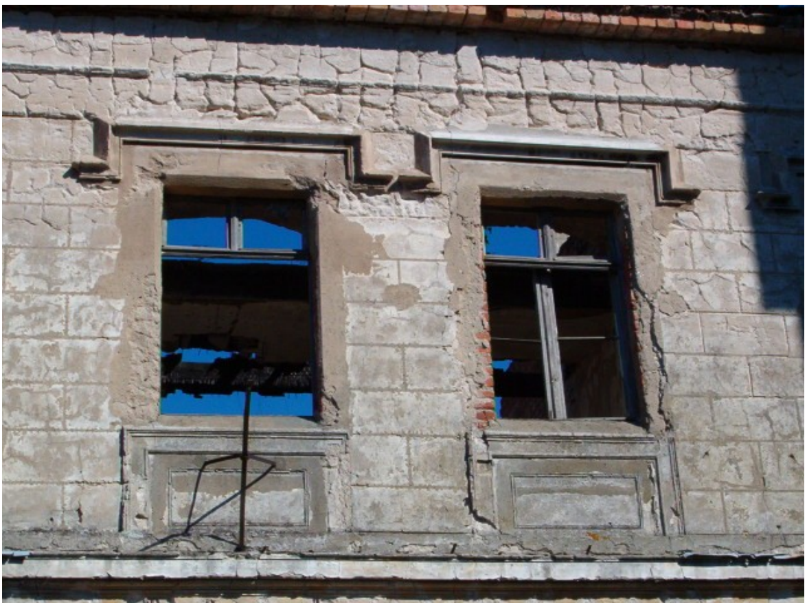
Fot. 11. Okna elewacji frontowej (II i III oś od lewej).
