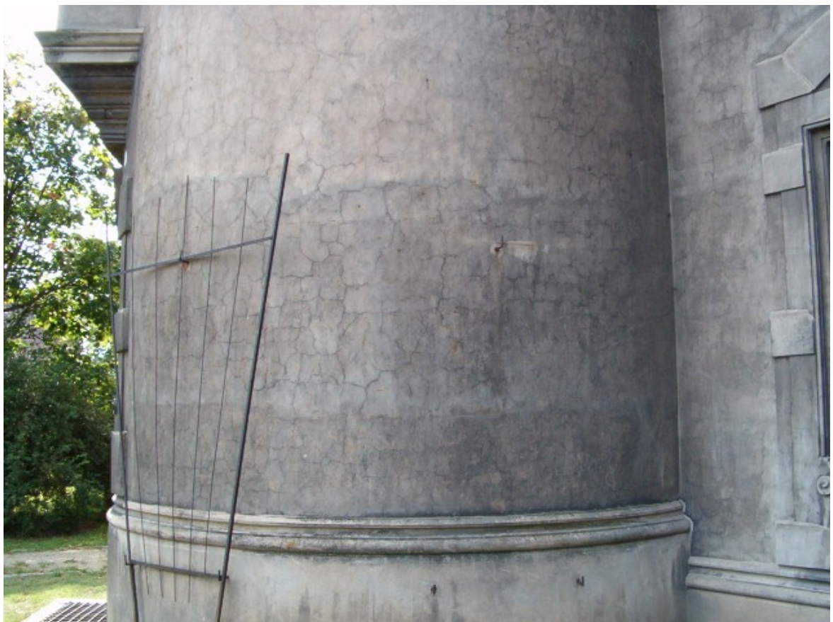
Fot. 108. Spękania tynku południowej cylindrycznej wieży.
