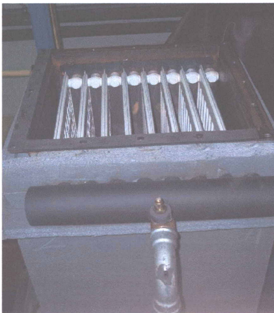
Rysunek 4.4.6. Zaizolowany wymiennik płytowy WO5 z widocznym kolektorem wylotowym
