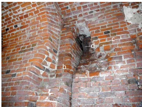
Ryc. 21. Wieża Klesza na Zamku Wysokim w Malborku. Piwnica, pomieszczenie nr 01. Obmurowany filar w ścianie zachodniej. Oznaczenia: a – struktura filara, b – dostawiona na styk ściana od strony południowej, c – uzupełnienie uskoku wraz ze sklepieniem kolebkowym, d – początek łuku ostrego w zwężonej strukturze filara (fot. M. Prarat, 2015)
