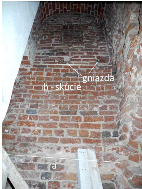
Ryc. 25. Wieża Klesza na Zamku Wysokim w Malborku. Piwnica, pomieszczenie nr 02. Ściana wschodnia. Oznaczenia: a – nadwieszka, b – mur skuty, powyżej dwa gniazda najprawdopodobniej po belkach stropowych (fot. M. Prarat, 2015)
