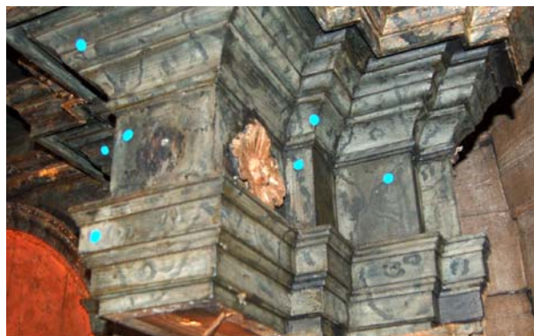
Ryc. 2. Żyłkowanie w strefie gzymsu. Polichromia zawiera smaltę, która korodowała, tworząc szaro-zielonkawe zaciek
