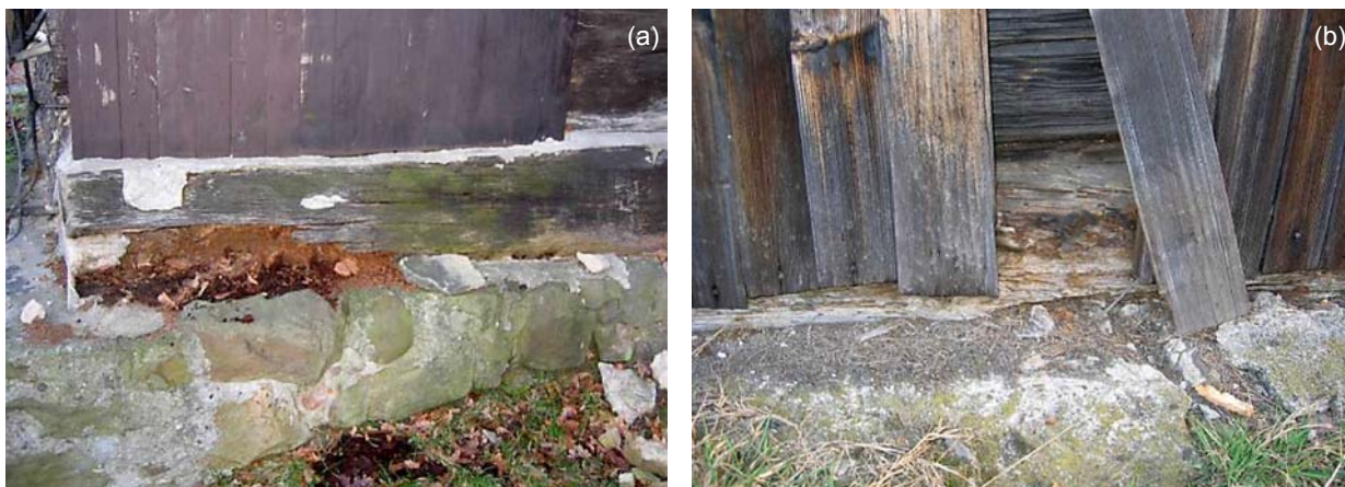
Ryc. 5. Korozja biologiczna podwalin: a) kościół pw. św. Marii Magdaleny w Bełku (XVIII w.) – podwalina na podmurówce kamiennej, b) kościół pw. św. Bartłomieja w Smolnicy (XVII w.) – podwalina na gruncie (w narożach ścian fundamentowe bloki kamienne)
