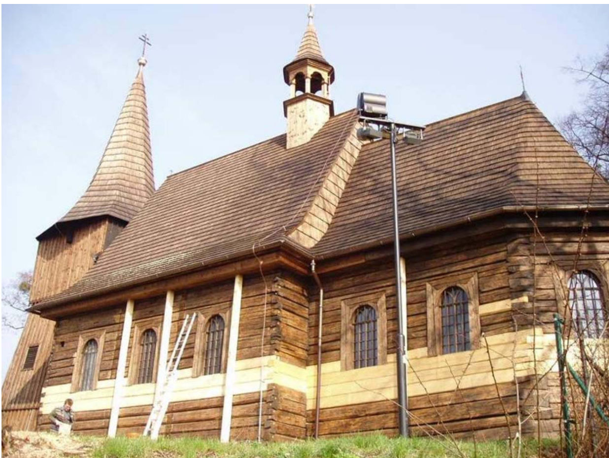
Ryc. 12. Wymiana elementów ścian i lisic w kościele pw. św. Michała Archanioła w Żernicy Fig. 12. Replacing parts of the walls of the St. Michael the Archangel church in Żernica
