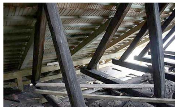
Ryc. 3. Namurnice i przypustnice oraz pokrycie dachu w trakcie remontu w kościele pw. św. Bartłomieja w Gliwicach
