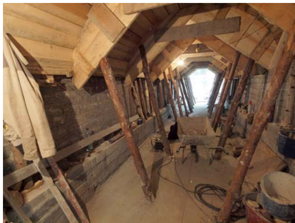
Ryc. 12. Wnętrze kanału pod budynkiem barokowym w trakcie przemurowywania ścian podłużnych; kolebka zabezpieczona krążyną i stemplami
