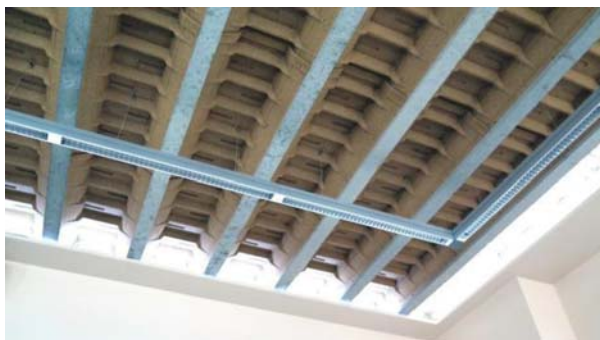
Rectolight bez sufitów podwieszanych
