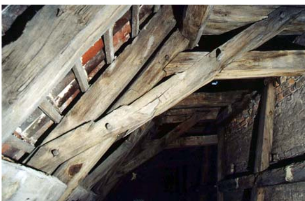
Ryc. 24. Złamany zastrzał w nawie bocznej
