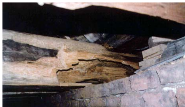
Ryc. 20. Przykład uszkodzenia końcówki belki stropowej przez grzyb domowy Fig. 20. Example of damage to a floor beam tip due to house fungus
