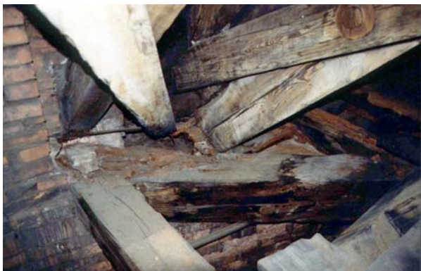
Ryc. 17. Uszkodzona strefa podporowa wiaźara pełnego Fig. 17. Damaged support section of main truss
