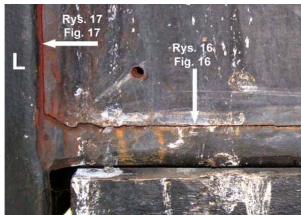
Ryc. 15. Pęknięcia spoin poziomej i pionowej Fig. 15. Cracks in horizontal and vertical welds
