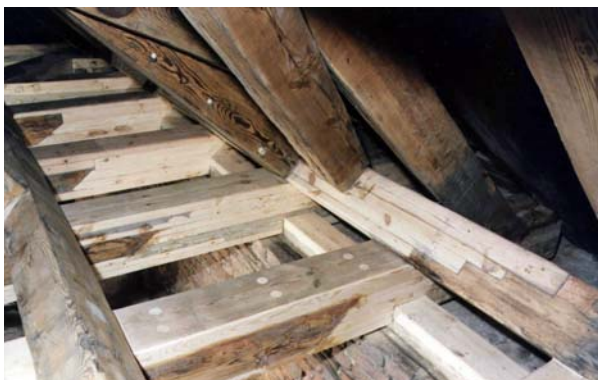
Ryc. 21. Zrekonstruowane podwaliny i końcówki belek stropowych. Widok z góry Fig. 21. Reconstructed ground beams and floor beams tips – top view
