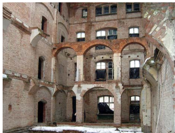
Ryc.9. Bydgoszcz, młyn Rothera, wnętrze budynku głównego, część wschodnia. W tej części pierwotnie zlokalizowana była klatka schodowa z galerią oraz pomieszczenia biurowe i administracyjne (fot. R. Sochaczewski, 2011)
