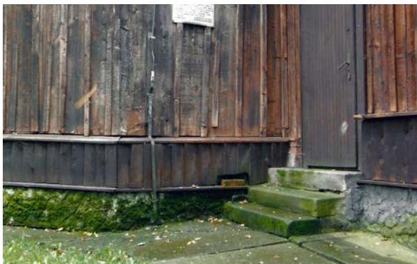
Ryc. 10. Fragment zniszczonego szalunku ścian prezbiterium i cokolu. Uszkodzone schody betonowe wiodące do zakrystii oraz przypadkowo dobrane drzwi zewnętrzne. Stan w 2010 r.
