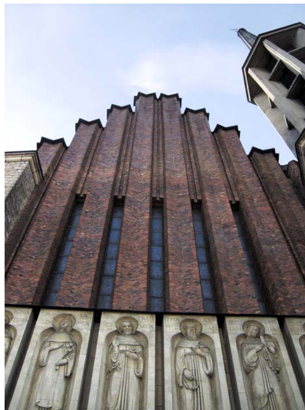
Ryc. 6. Odchylenia sterczyn na fasadzie głównej, fot. M. Łaba, październik 2011 Fig. 6. Deviations of pinnacles on the main facade, photo: M. Łaba, October 2011
