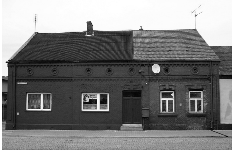
II. 5. Koziegłowy – brak spójności elewacji i widoczny podział własnościowy (fot. K. Mazur-Belzyt)
