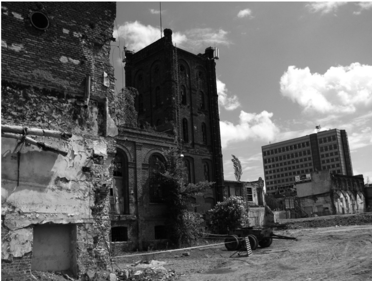
II. 3. Wyburzenia na terenie zespołu fabrycznego Geyera w Łodzi – przy ul. Piotrkowskiej (fot. B. Wycichowska, 2011)
