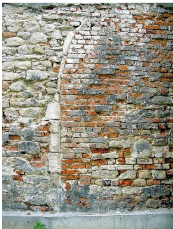
Ryc. 2. Wodzisław Śląski, kościół pofranciszkański. Ściana południowa nawy, przęsło środkowe. Węgar gotyckiego portalu dołem zamurowanego wtórnie użytyymi gotyckimi ceglami i ciosami, a u góry cegłą barokową i maszynową (fot. J. Węćławowicz, 2008)
