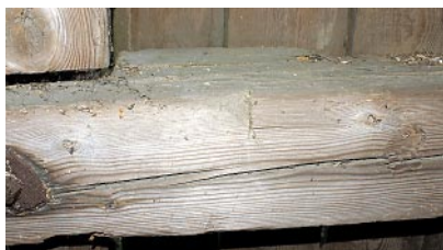
Ryc. 10. Bierzłowo, wiatrak koźlak z 1867 r. Rygiel ściany prawej z widocznym zacięciem – śladem po transporcie budulca (oprac. M. Prarat, 2010) Fig. 10. Bierzłowo, post mill from 1867. Spandrel beam of the right-hand wall with a visible notch – a trace of transporting the building material (made by M. Prarat, 2010)
