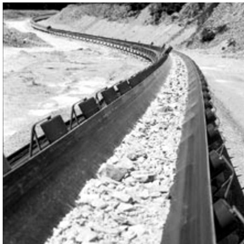
Rys 1. Widok przenośnika taśmowego o znacznej długości i wydajności Fig. 1 View of belt conveyor, considerable length and capacity
