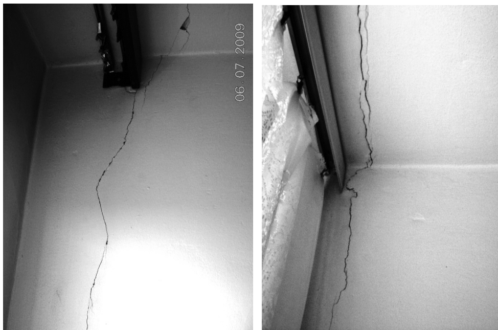
II. 6. Zarysowania ścianek działowych w obszarze zewnętrznych ścian balkonowych
