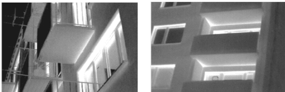
Il. 3. Mostki cieplne w miejscu połączenia płyty balkonowej ze ścianą (oprac. P. Gałek)
