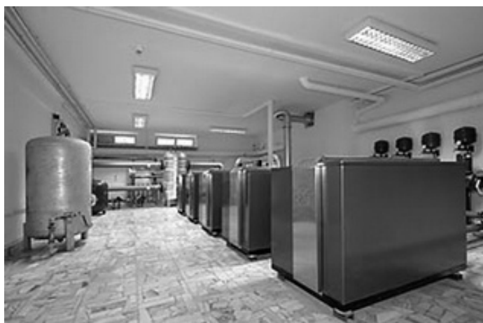
II. 1. Instalacja pomp ciepła VATRA w Domu Dialogu i Modlitwy w Oświęcimiu
