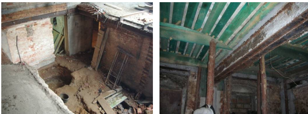
Rys. 14, 15. Usunięty fragment stropu odcinkowego nad piwnicą i roboty związane z jego odtwarzaniem. Fot. Archiwum Studio-Projekt, 2007 r.
