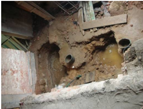
Rys. 12. Wysoki poziom wód gruntowych w piwnicy. Fot. Archiwum Studio-Projekt, 2007 r.
