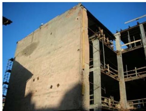
Rys. 17. Zachowane fragmenty innych ścian budynku. Fot. Archiwum Studio-Projekt, 2007 r.
