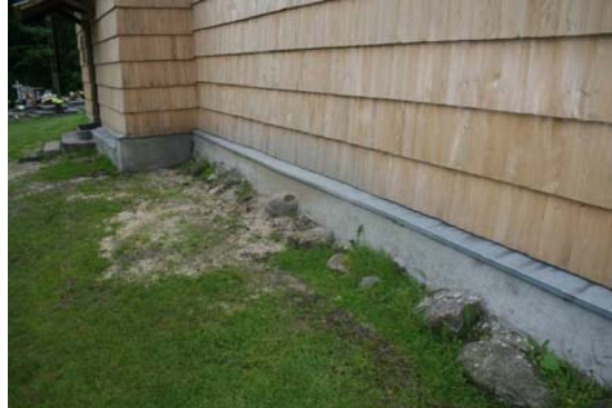
Rys. 7. Otynkowane mury fundamentowe wraz z obróbką blacharską - rozwiązanie zgodne ze sztuką budowlaną lecz sprzeczne z kanonami sztuki konserwatorskiej (kościół p.w. Najświętszej Marii Panny w Szalszy z XVII w.)
