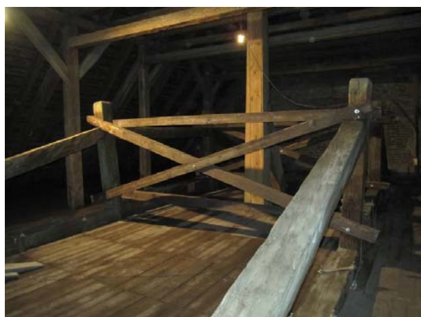
Rys. 16. Wykonane stężenie wieszarów stropowych nawy kościoła p.w. Podwyższenia Krzyża Świętego w Sławkowie
