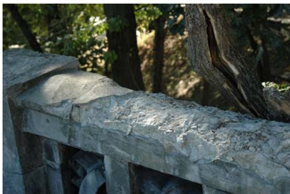
Rys. 5. Widok zniszczonej balustrady betonowej [7]
