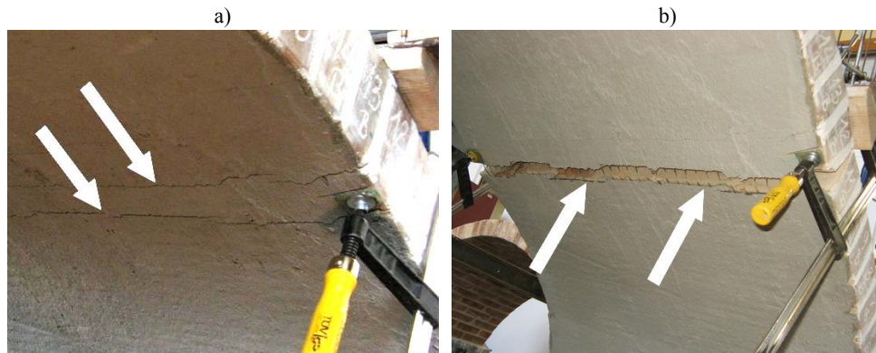
Rys. 18. Uszkodzenia elementu S05W:
