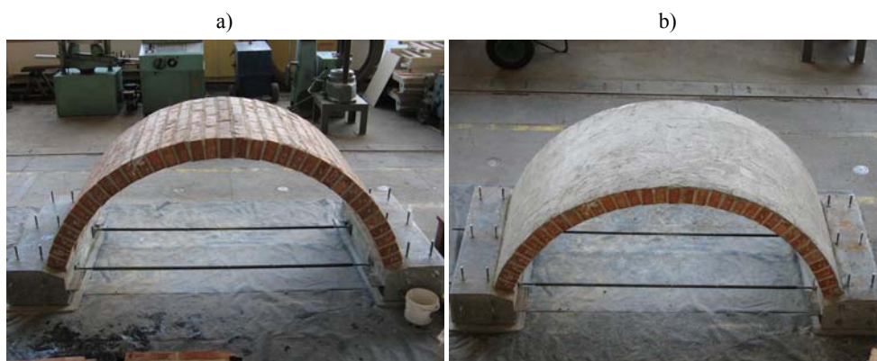
Rys. 12. Widok elementu S02W: a) przed wzmocnieniem, po wypełnieniu rys iniektm, b) po wzmocnieniu
