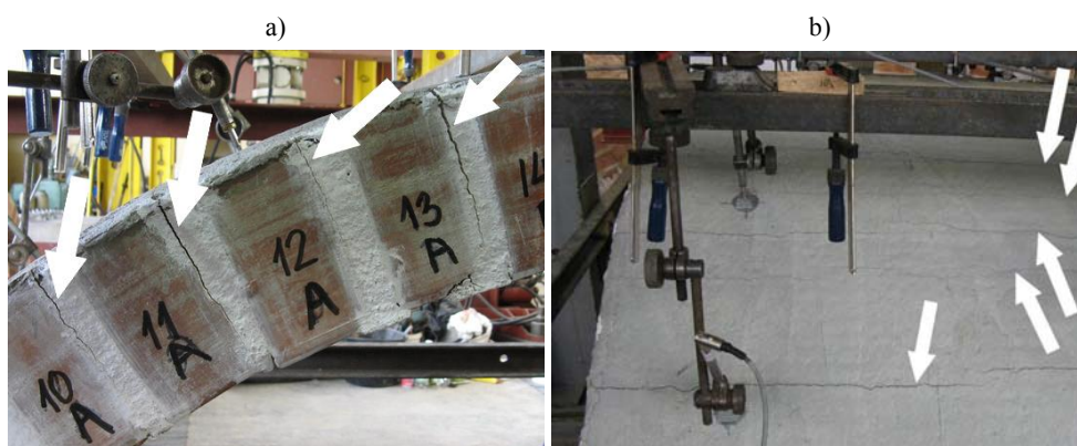
Rys. 13. Uszkodzenia elementu S03W: a) zarysowanie w spoinach wspornych w strefie powstania rys we wzmocnieniu – w trakcie badania, b) pęknięcia w matrycy wzmocnienia, widok powierzchni grzbietowej – w trakcie badania
