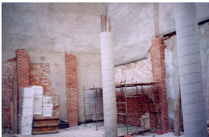
Rys. 19. Wzmocnienie ścian ceglanych pilastrami ceglany oraz przygotowanie słupów żelbetowych do oparcia stropów żelbetowych w obiekcie zabytkowym
