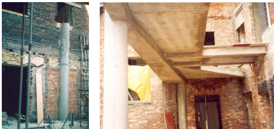
Rys. 18. Zastosowanie słupów żelbetowych do przejścia obciążeń ze stropów żelbetowych w modernizowanym budynku zabytkowym
