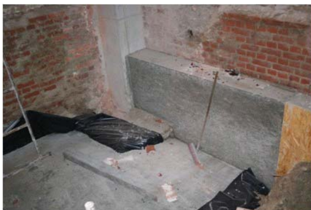
Rys. 16. Widok podbicia (około 1,5 m) muru piwnicznego budynku zabytkowego (widok muru piwnicznego budynku zabytkowego)
