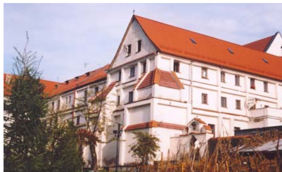
Rys. 11. Elewacja południowo-wschodnia z widocznymi ryglami i słupami wzmacniającymi klasztor Fig. 11. South-east elevation with visible beams and columns strengthening the monastery
