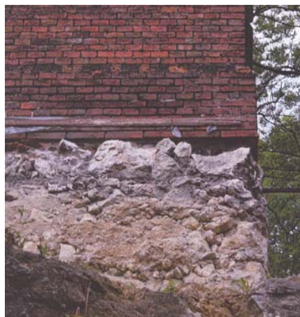
Rys. 15. Widok wypadających kamieni z fundamentu i pęknięcia muru ceglanego dzwonnicy
