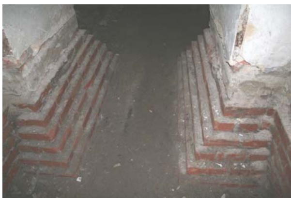
Rys. 6. Przykład odkopanych fundamentów w obiekcie zabytkowym z elementów ceramicznych wykonanych na zaprawie wapiennej
