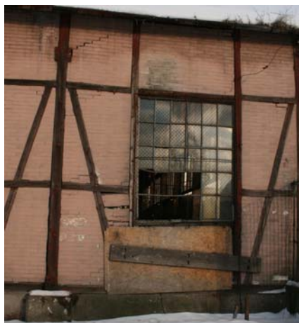
Rys. 12. Ściana tzw. mur pruski całkowicie zniszczony (widok ściany zach.)
