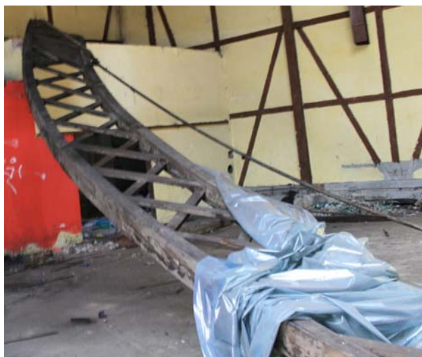
Rys. 7. Widok zawałonego wiaźara dachowego w osi 10
