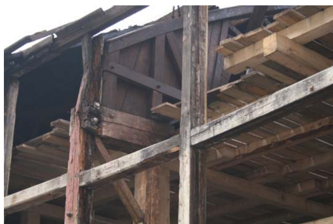
Rys. 11. Oparcie dźwigara dachowego na skorodowanej części słupa drewnianego dwugłęziowego
