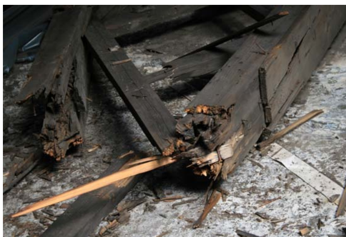
Rys. 8. Widok złamanych pasów wiaźara dachowego
