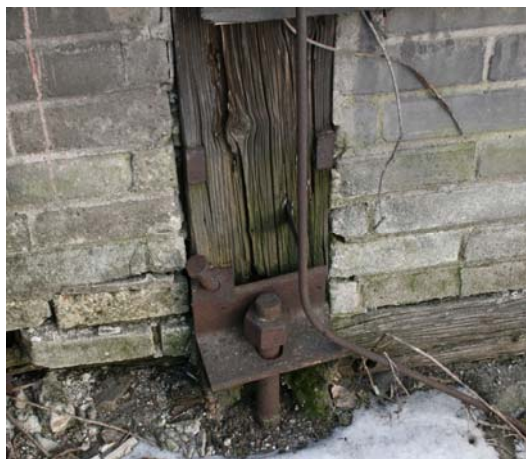
Rys. 13. Mur pruski bez belki podwalinowej (zniszczenie na skutek korozji)
