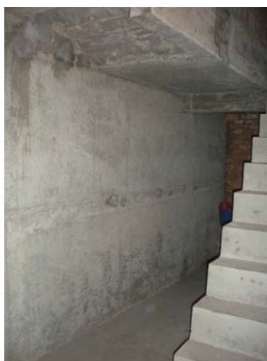
Rys. 3. Kraków, ul. Pijarska 7. Klatka schodowa w obrębie piwnicy po remoncie. Kamienną ścianę wsparto na oczepach mikropali i zabezpieczono żelbetowym płaszczem
