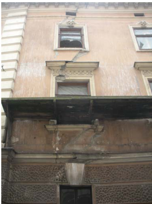
Rys. 4. Kraków, ul. Św. Marka 19. Przemieszczenie widoczne na elewacji na styku z podpiwniczonym budynkiem frontowym przy Floriańskiej 26
