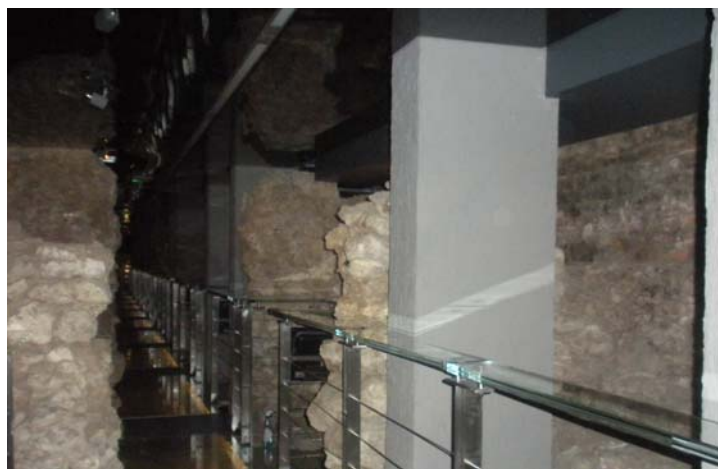
Rys. 10. Kramy Bogate. Żelbetowe słupy na mikropalach niosące belkę płyty Fig. 10. Cracow, the Kramy Bogate. Reinforced concrete posts on micropiles carrying the plate beam
