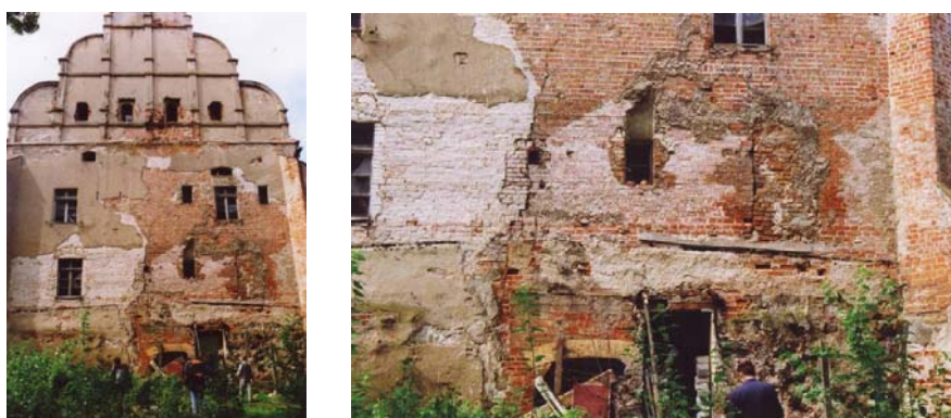
Rys. 8. Zamek w Giżycku – wschodnia ściana szczytowa, widoczne uszkodzenia ściany oraz zachowane fragmenty tynku
