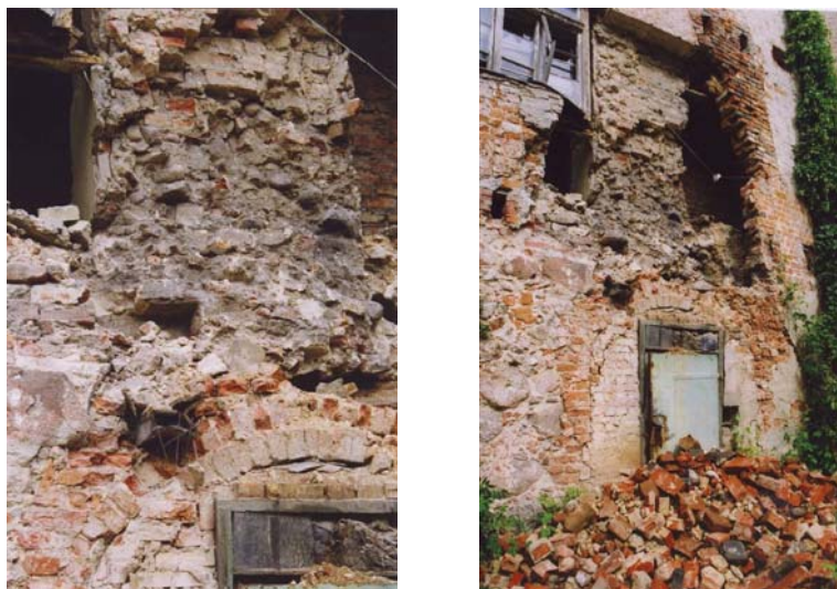
Rys. 11. Zamek w Giżycku, uszkodzony awarią fragment ściany południowej, po prawej wewnątrz uszkodzonego muru wykonane z zalanej zaprawą gruzu ceglanego
