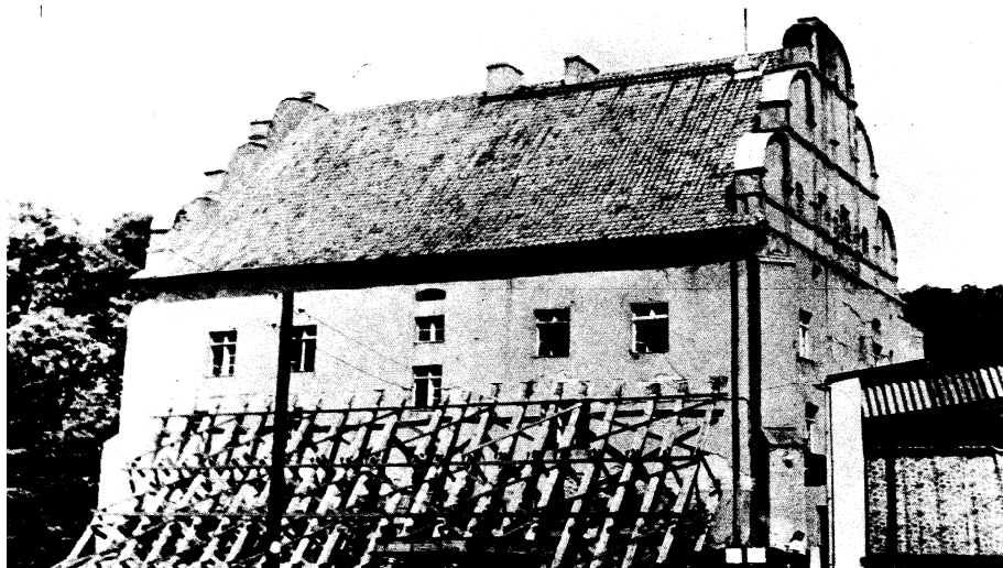
Rys. 6. Zamek w Giżycku, ściana południowa podparta drewnianymi zastrzałami
