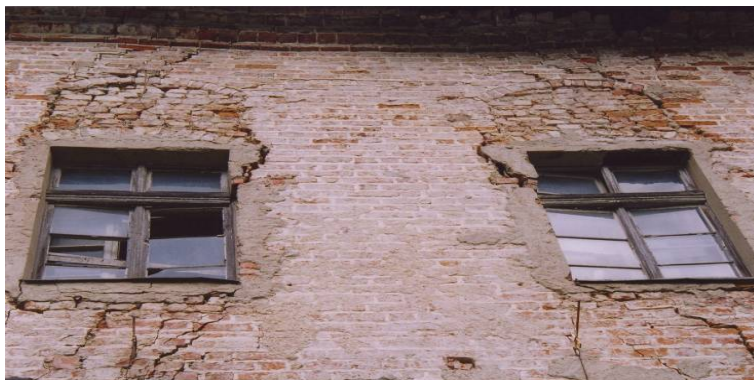
Rys. 9. Zamek w Giżycku - ściana południowa, widoczne liczne przemurowania oraz spękania muru
