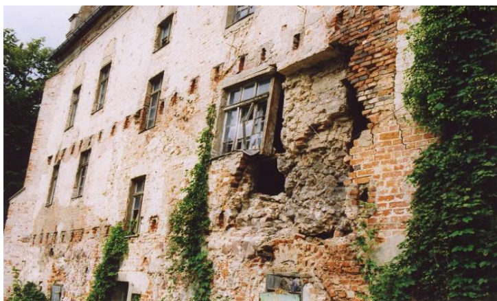
Rys. 1. Zamek w Giżycku, elewacja południowa, widoczne uszkodzenia pld. – wsch. narożnika po awarii ściany w dniu 6 sierpnia 2007 r.
