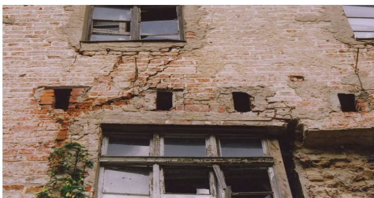
Rys. 10. Zamek w Giżycku – ściana południowa, widoczne: spękania muru, gniazda po usuniętych zastrzałach, wtórne przemurowania
