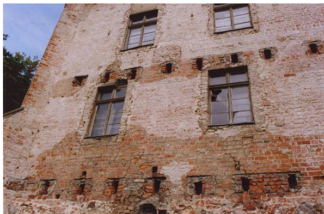
Rys. 7. Zamek w Giżycku – fragment ściany południowej, widoczne wykute w murze gniazda, pozostałe po drewnianych zastrzałach wcześniej podpierających ścianę
