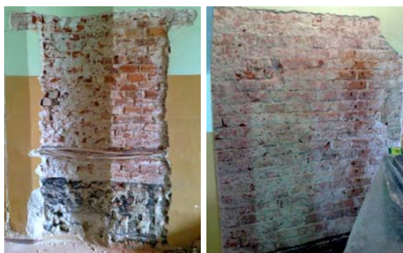
Rys. 5. Fragment muru zabytkowego przeznaczony do usunięcia (wykorzystany do badań)
