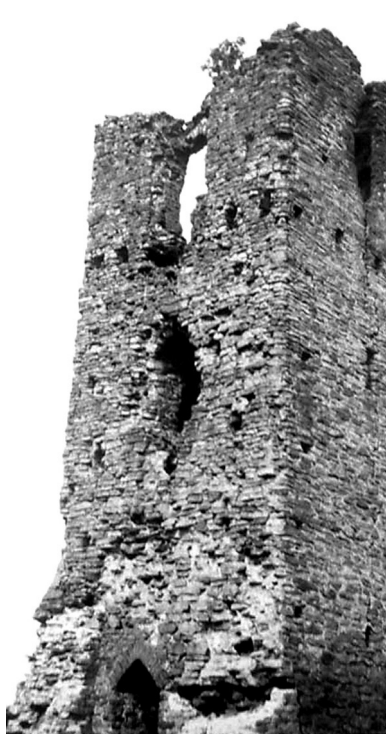
II. 5. Silnie zniszczona ściana zachodnia wieży z widocznymi pozostałościami przypór – stan z początku XX w. (archiwum IHKM RAN w Sankt Petersburgu)
