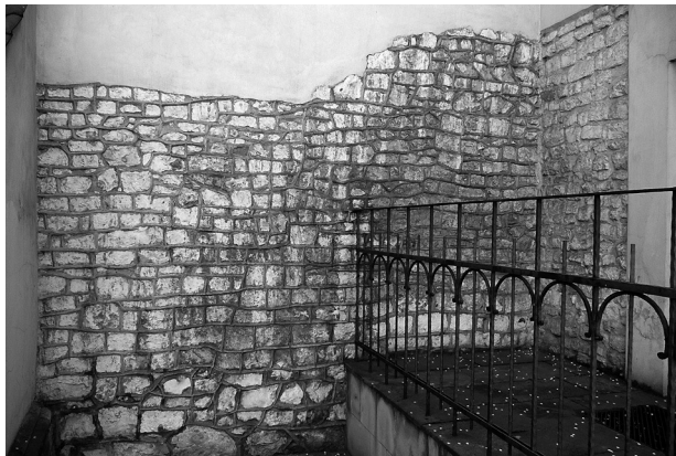
Il. 2. Kraków, kościół św. Mikołaja. W ścianie gotyckiego prezbiterium wtórnie ułożone kostki z rozebranego kościoła romańskiego. Fot. J. Firlet
