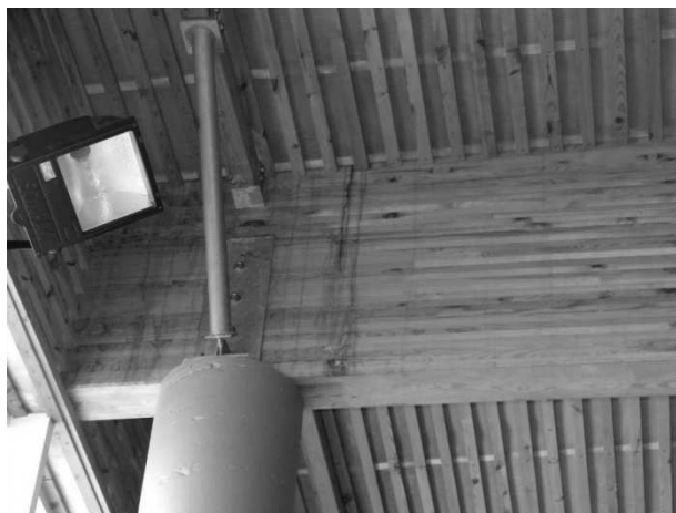
Fot. 1. Podpora dachowego dźwigara z drewna klejonego – widoczne zacieki na powierzchni bocznej dźwigara
